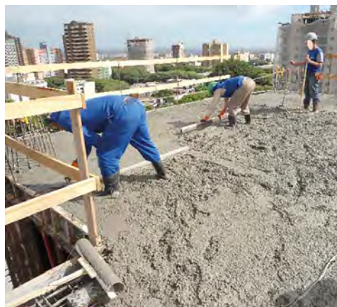
Figura 3.4 – Sistema de guarda-corpo e rodapés e linha de vida ineficazes em locais de realização de serviços em altura
