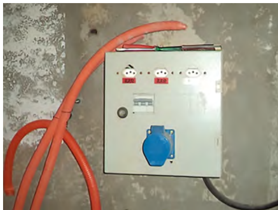
Figura 4.16 – Plugues e Tomadas blindadas em canteiro de obras
