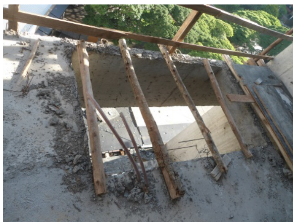
Figura 3.2 – Fechamento provisório incompleto de um vão em pavimento
