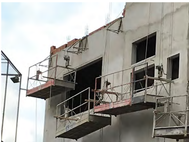
Figura 1.2 – Andaimos suspensos fixados na estrutura da edificação com emprego de afastadores metálicos e cabos de aço
