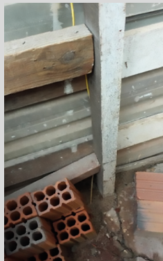
Figura 4.33 – Aterramento da obra
