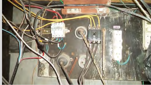
Figura 4.36 – Quadro de energia improvisado
