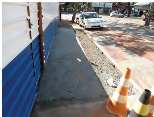
Figura 1.13 – Condições de calçadas em frente ao tapume
