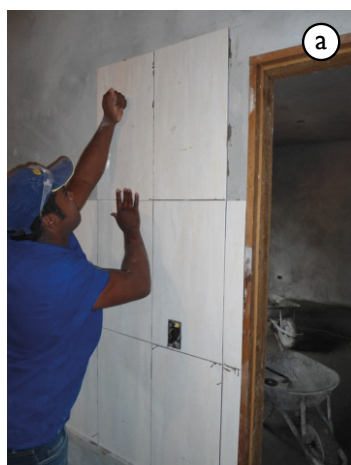
Falta de andaime
