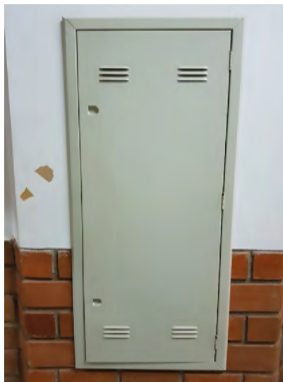
Figura 4.5 – Quadro de distribuição fechado
