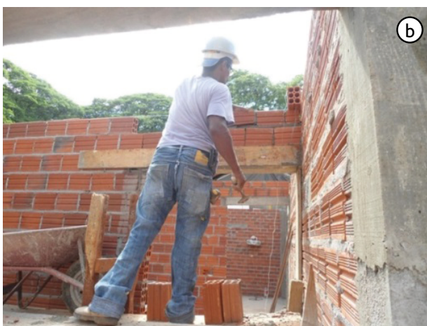
Ausência de complemento para andaime
