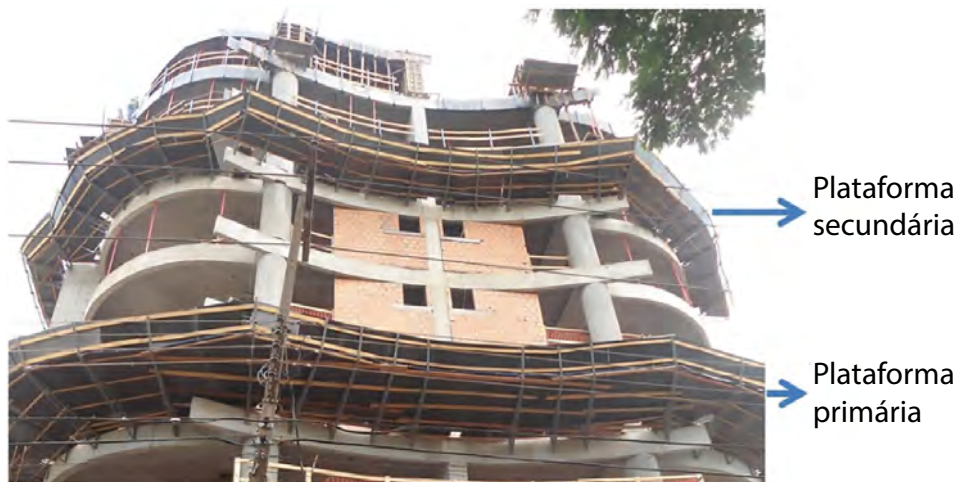
Figura 3.20 – Plataformas primária e secundária em utilização
