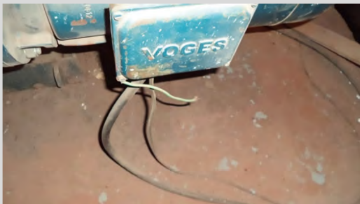
Figura 4.35 – Fio terra do motor do elevador
